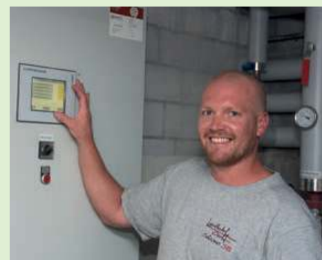
Haustechniker Pascal Joder vor der Steuerungseinheit
