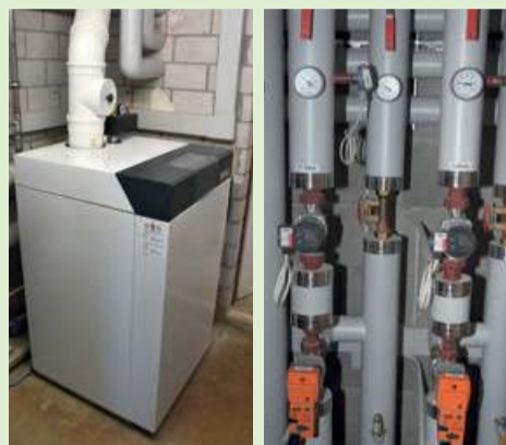
Erdgasheizung und Heizungsverteiler im ehemaligen Tankraum
