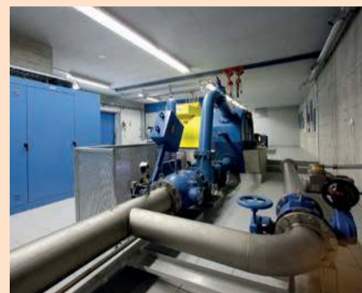
Hier wird BödeliBlaustrom produziert: Innenansicht des Trinkwasserkraftwerks Geissbrunnen
